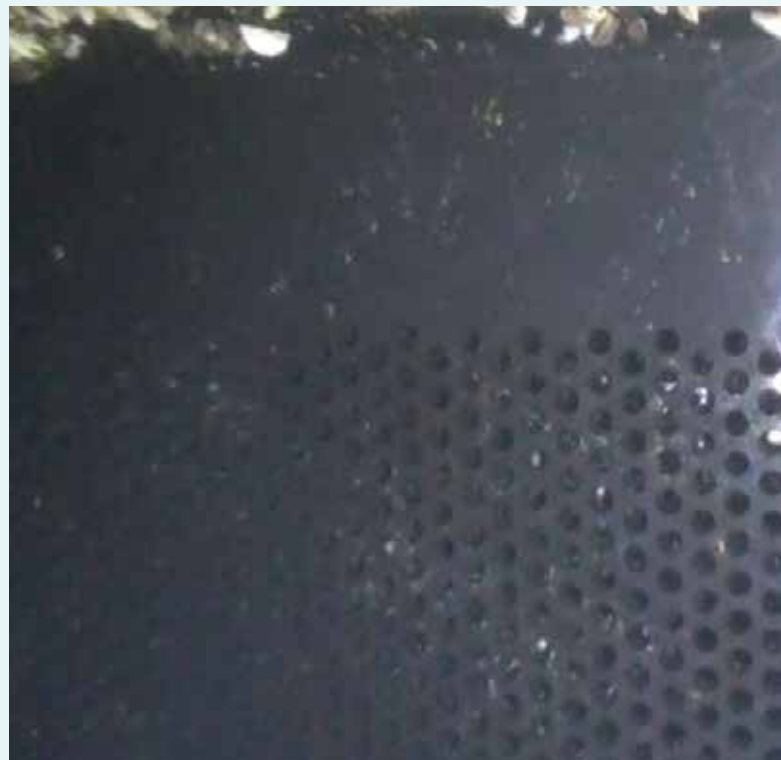
Crépine après le nettoyage
